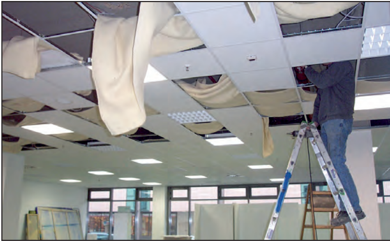
Abbildung: Gesundheitshaus Leverkusen – Im Jahr 2002/3 wurden 7.000 m 2 Keratinvlies im Deckenbereich zur Reduktion vor allem möglicher nachträglich eingebrachter Emissionen (Möbel, Geräte, Bodenbeläge) präventiv eingebaut.
