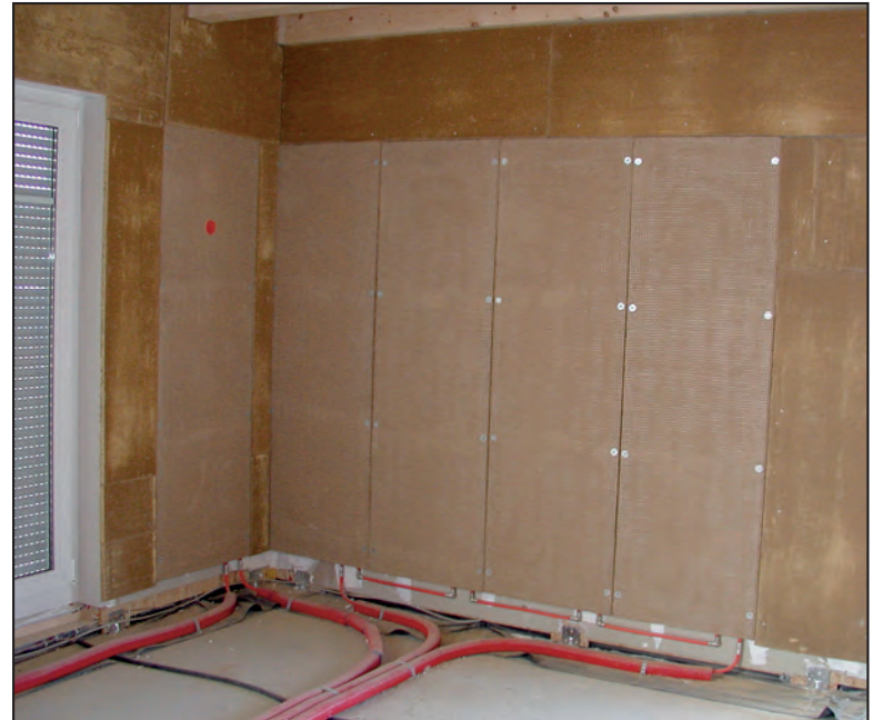
Ausgeglichene Raumwärme durch Wandheizungen mit Lehmwänden
