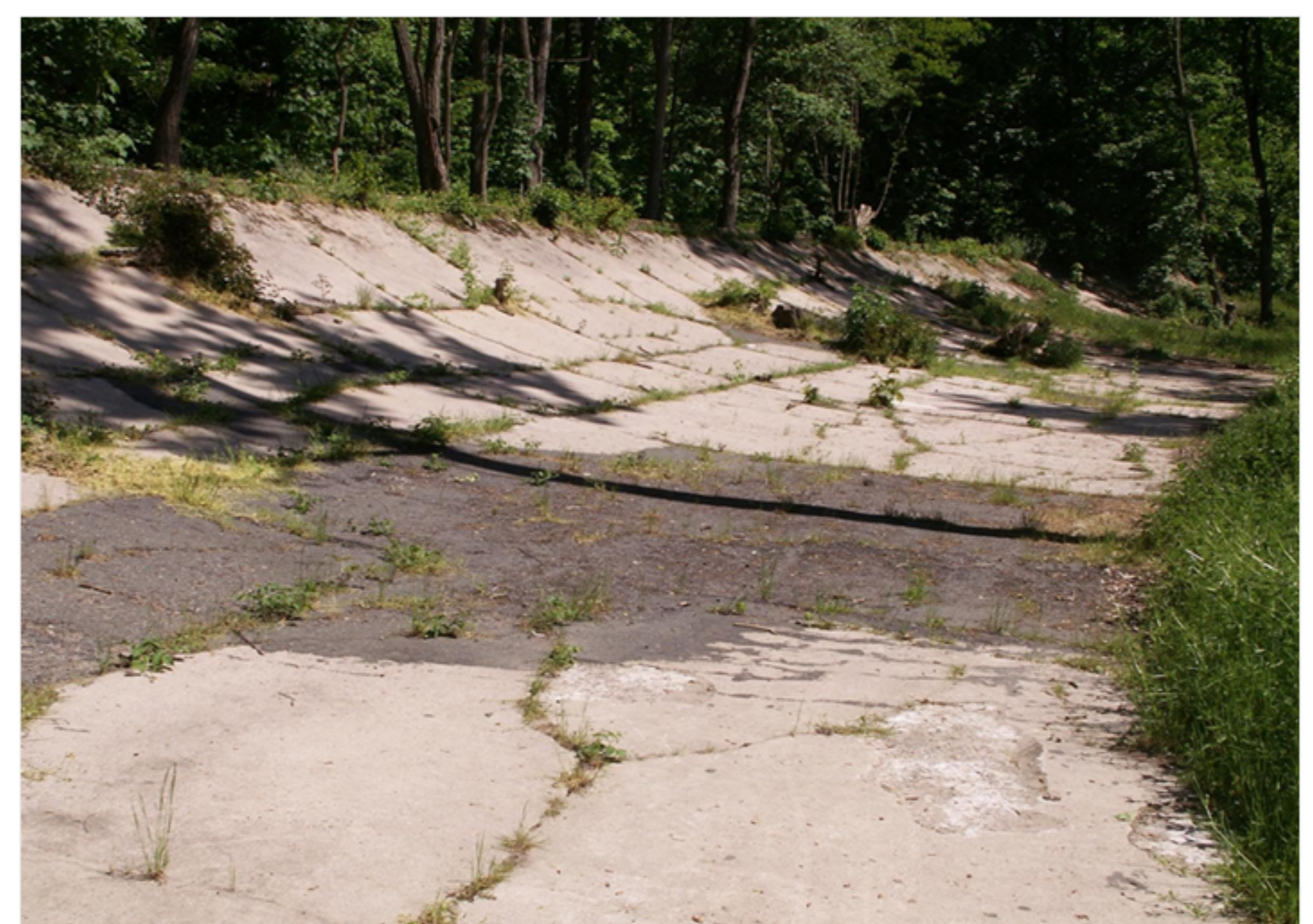
Zustand der Opelbahn 2019
